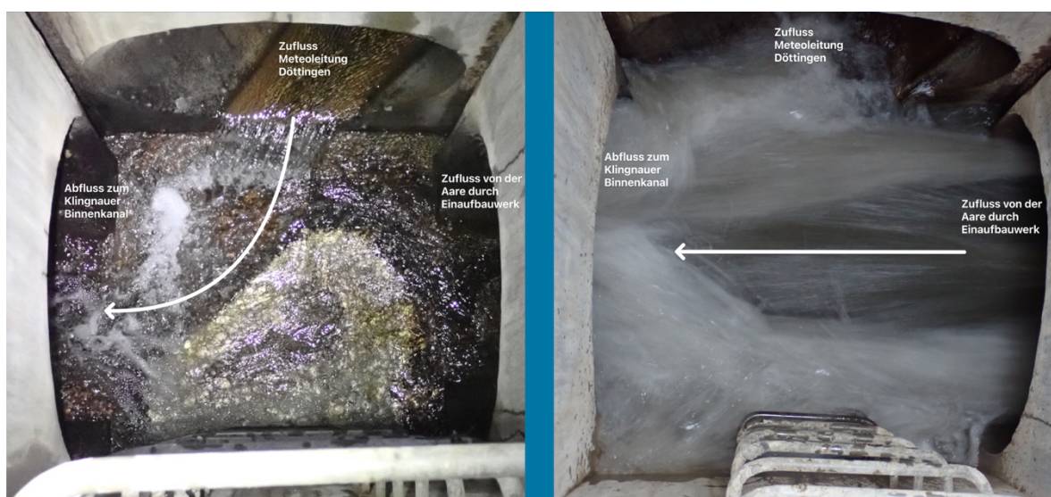
Abbildung 6: Einblick in das Rohrkreuz, links im Normalzustand (wegen viel Niederschlag gefüllt mit Meteowasser), rechts während der Spülung
