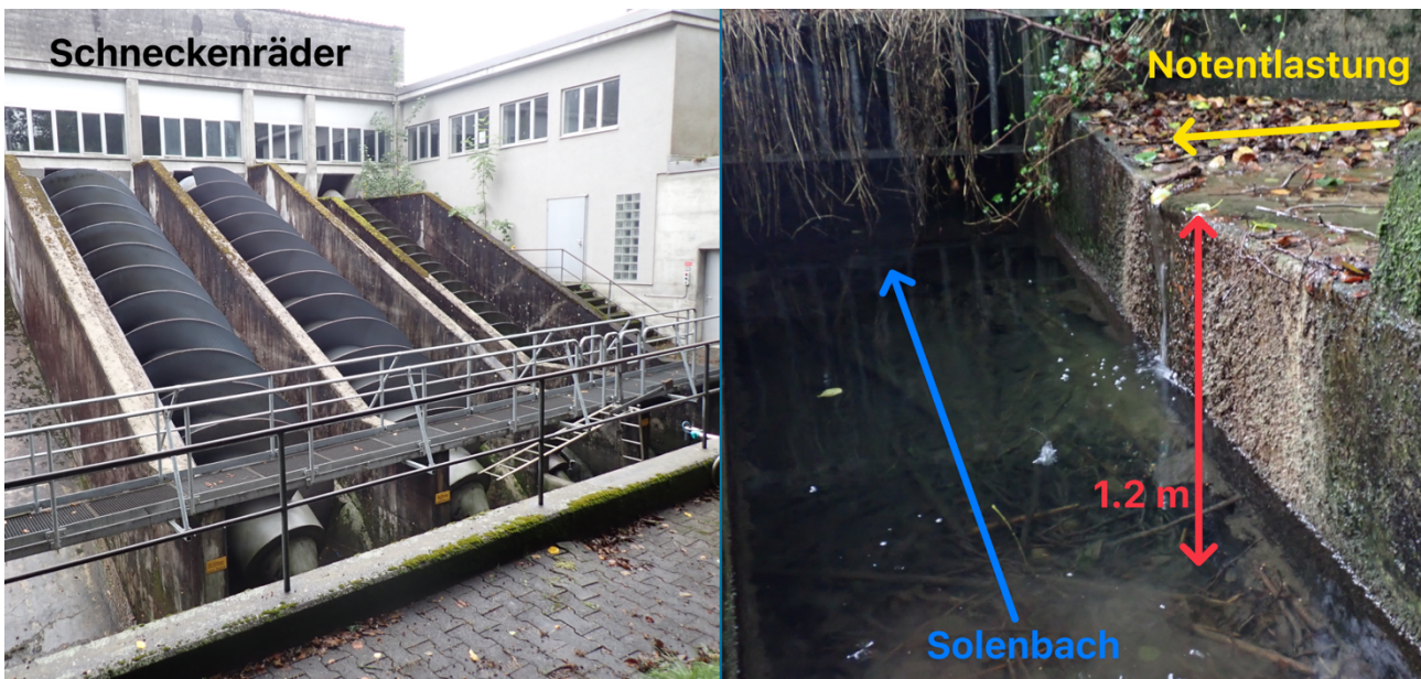
Abbildung 10: Detailaufnahmen des Abwasserpumpwerks, links: die drei Schneckenräder, rechts: Übergang vom Solenbach zur Notentlastung
